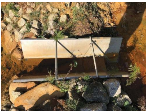
Fig. 3. Aforador tipo RBC instalado aguas abajo del terraplén.
